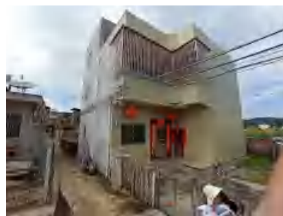
电力电信线缆
